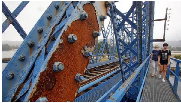
Figura 1.11.-Deterioro por corrosión. Tomada de: González P. (2020)
