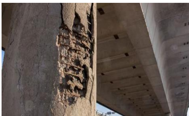
Figura 1.16.-Deterioros del concreto. Tomada de: UCSP, 2023
