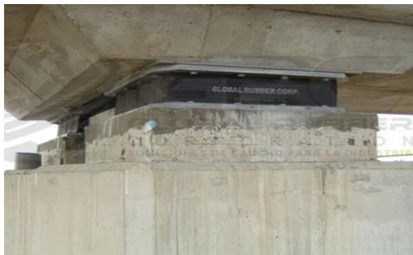
Figura 1.18.-Desgaste en los apoyos. Tomada de: GRC (2023)
