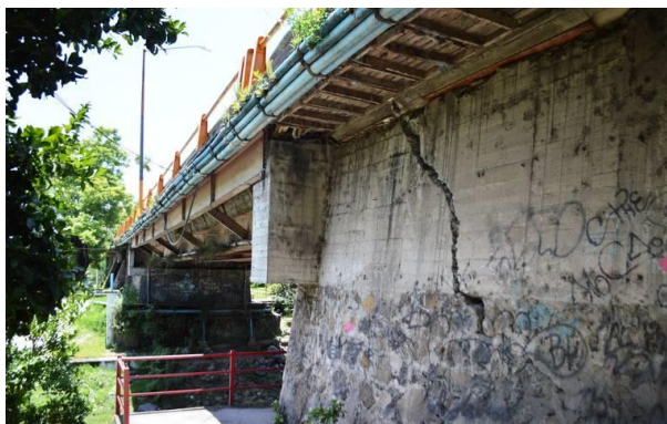
Figura 1.15.-Grietas y fisuras. Tomada de: Gaviña (2022)
