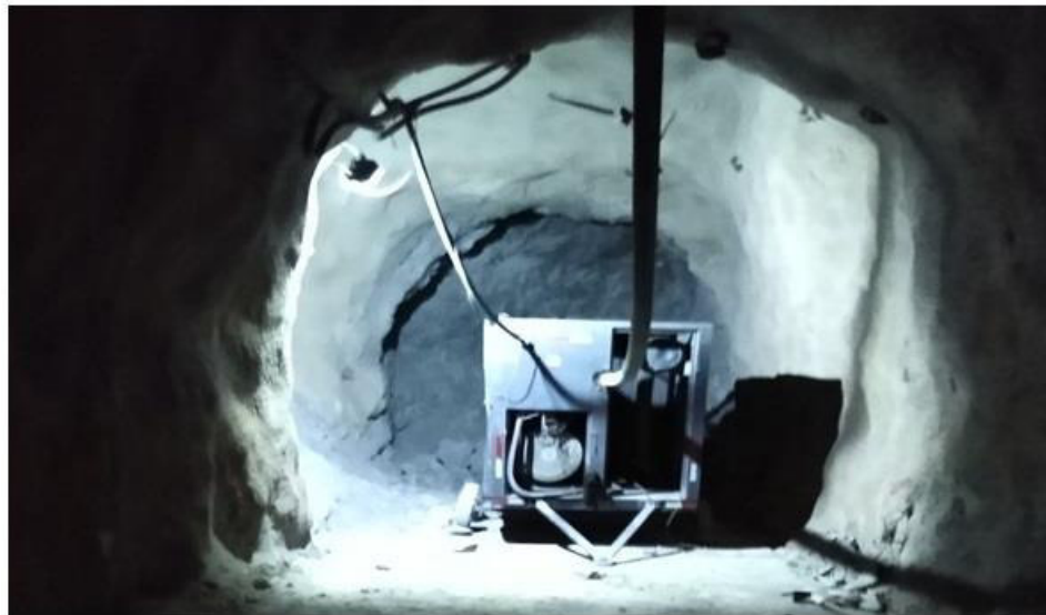
Figura 19. Compresor portátil para proporcionar servicio de aire al equipo de barrenación.
