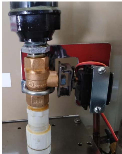
Figura 11. Servomotor montado a la válvula de cierre y apertura de flujómetro de aceite.
