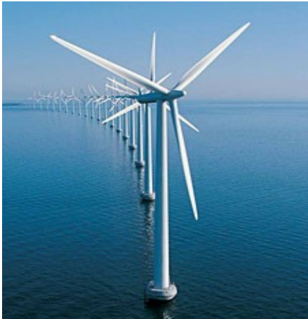
IMAGEN 1: Aerogenerador tripala de eje horizontal
