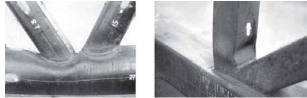
IMAGEN 3. Fallas en perfiles HSS debido a sus delgadas paredes y una distribución no uniforme de esfuerzos. Packer, J. [5]
