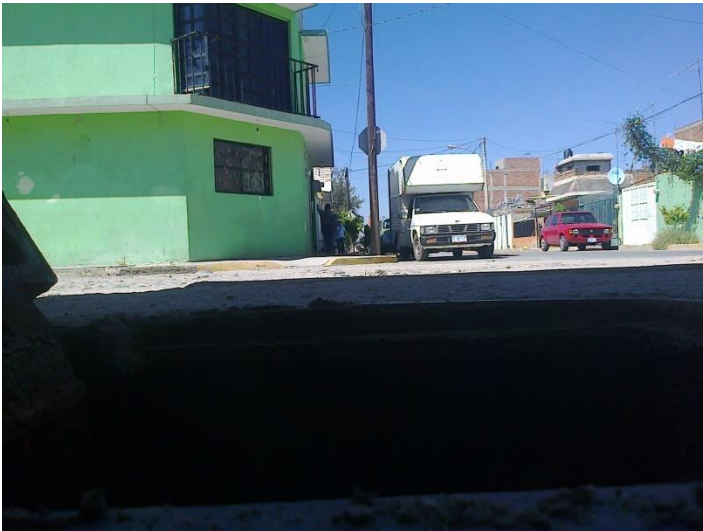
Obtención de información en campo de las instalaciones existente dentro tramo a intervenir
