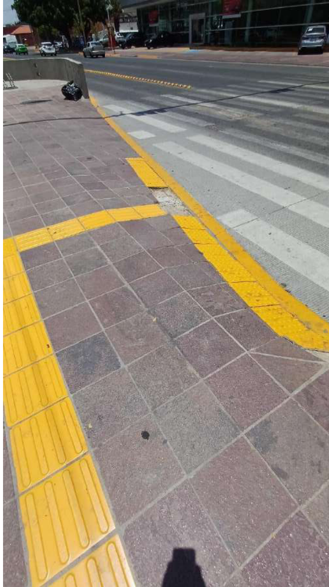
Fotografía 16. Guía podotáctil incompleta e incomunicada por un panel desprendido en el camellón de acceso a la estación intermedia de transferencia “Deportiva” y la conexión del cruce peatonal con la acera del Blvd Adolfo López Mateos. Autoría propia (2024).
