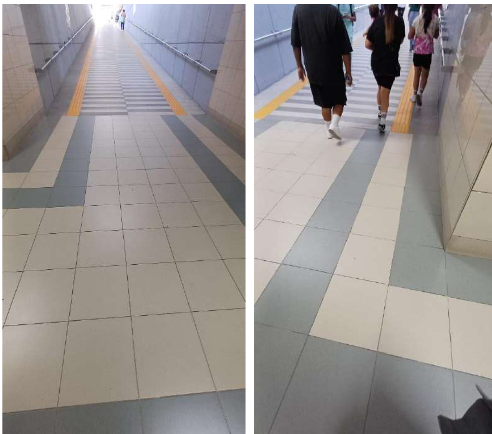
Fotografía 60 y 61. Desconexión e incomunicación de las guías de paneles podotáctiles a partir de los tuneles que comunican a las bahías de los andenes de la terminal de transferencia “San Jerónimo” entre sí y con la entrada/salida de la terminal. Autoría propia (2024)
