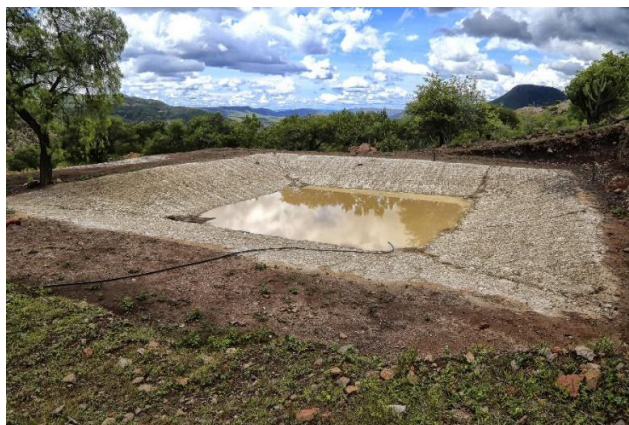
Figura 8. Jagüey para captación e infiltración de agua pluvial construido como parte del proyecto “Agua para Siempre”. Recuperada de Méndez (2019).
